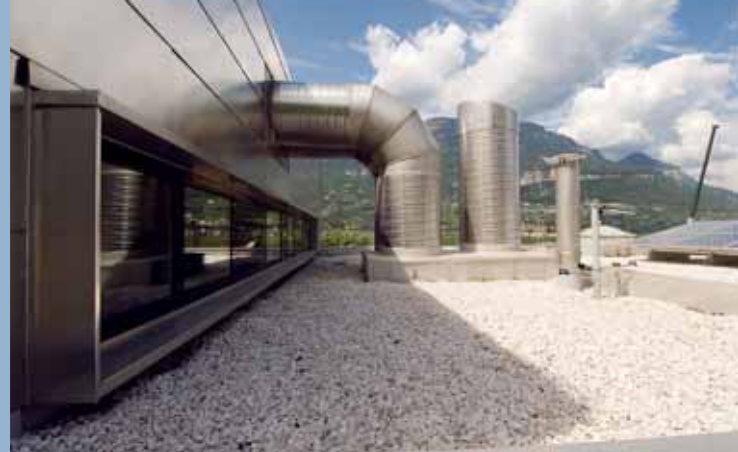
Presa d'aria esterna per l'impianti di ventilazione controllata
