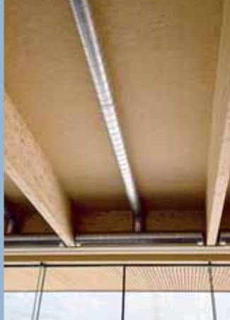
Condotta di ventilazione
