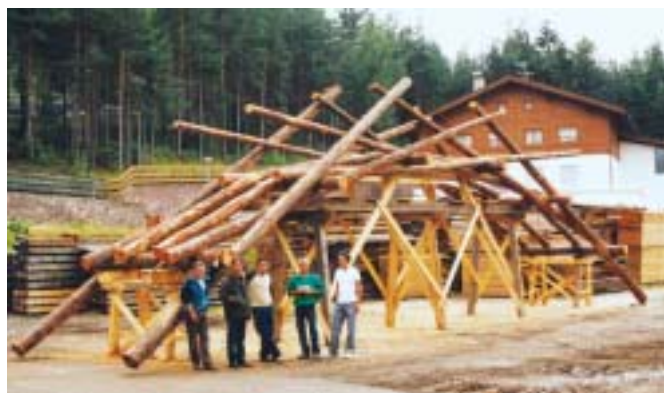
Bild 9: Richtfest der Brückenkonstruktion auf dem Abbundplatz. Die Studenten der Universität Innsbruck halfen beim Aufbau.
